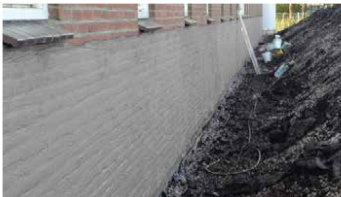
Kellarin ulkopuolinen vedeneristys
